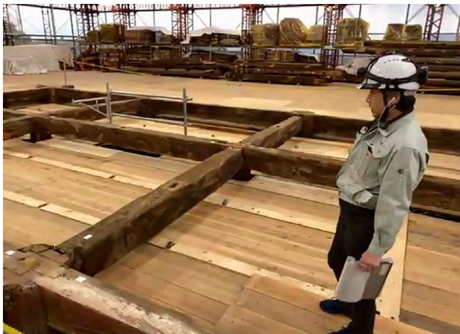
照片 9： 末端开有孔洞的梁
